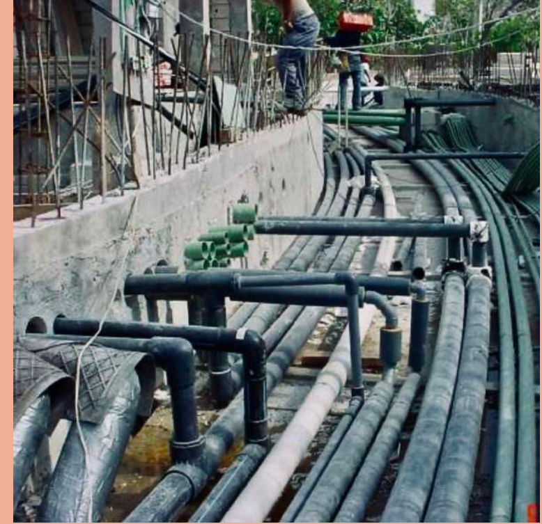
Figura 18: Instalaciones de trinchera. Por: LAAG.
