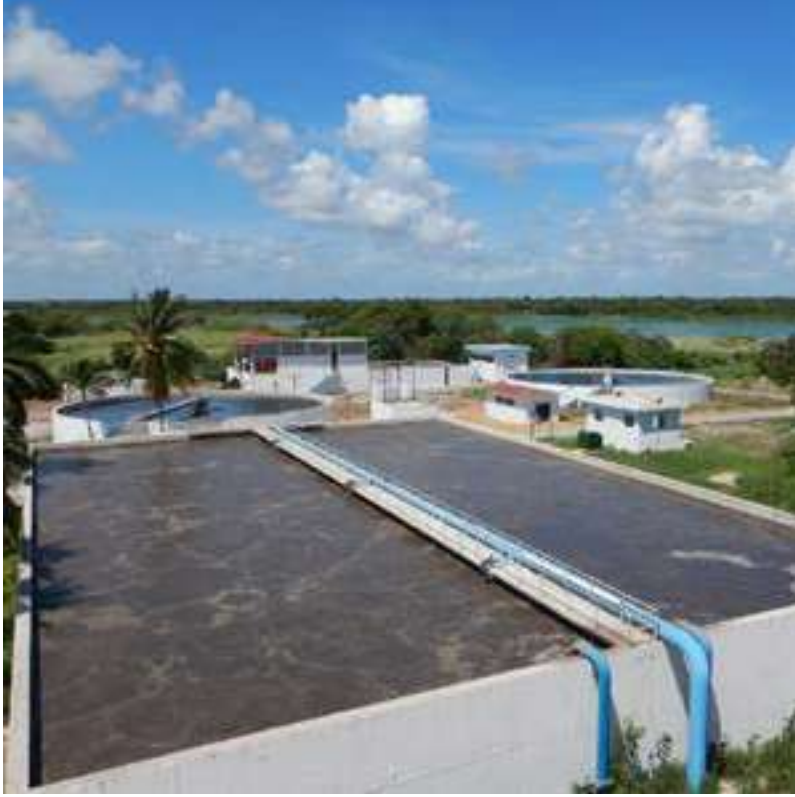
Figura 51: Planta de Tratamiento de Aguas Residuales por lodos activados y un Estero como cuerpo receptor del efluente.
