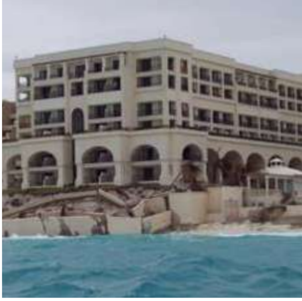
Figura 38: Ejemplo de desastre en construcciones sin muros de retención. Por: A&D asociados.
