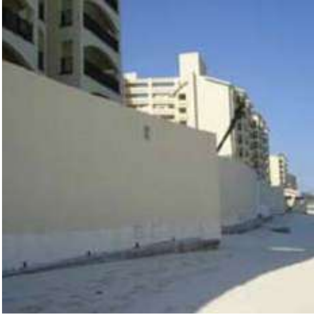
Figura 39: Muros de contención que resistieron las cargas por empuje de olas. Después del paso de Huracán Wilma, Cancún 2005. Fuente: SMIE
