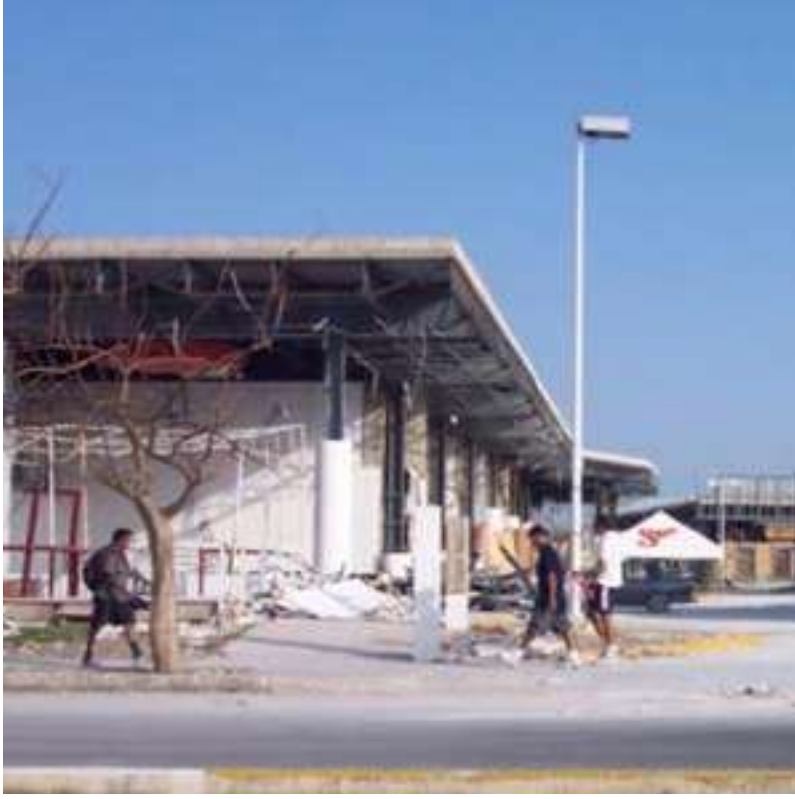
Figura 42: Locales comerciales en Plaza las Avenidas habiendo utilizado plafón en su exterior. Después del paso del huracán Wilma. Por: A&D asociados.
