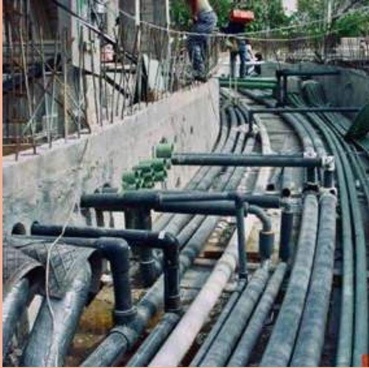
Figura 18: Instalaciones de trinchera. Por: LAAG.
