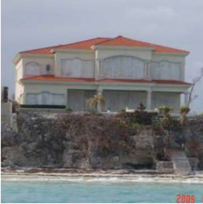
Figura 30: Ejemplo de techos principales de tejas. Después del huracán Wilma. Por: A&D asociados.
