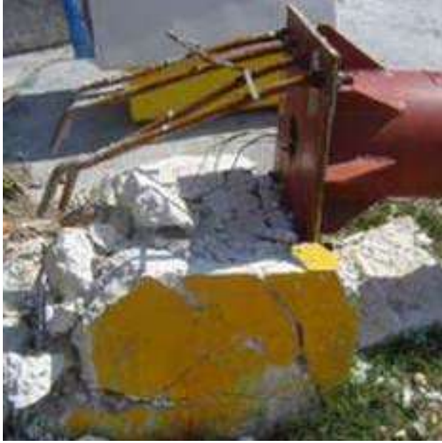
Figura 44: Fallas en postes por adherencia (derecha) y flexión (izquierda). Después del paso de Huracán Wilma, Cancún 2005. Fuente: SMIE
