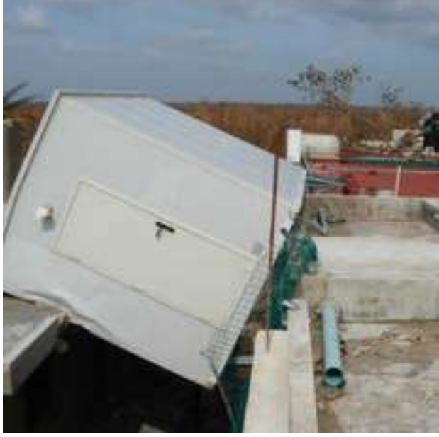
Figura 43: Ejemplo de equipo instalado en exterior después del paso del huracán Wilma. Por: A&D asociados.
