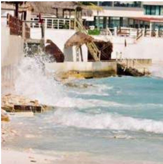
Figura 44: Oleaje en cimentación de las construcciones. Por: ASK-ECV.
